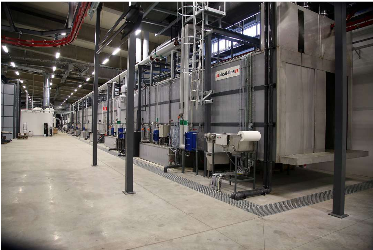
Förbehandlingsanläggning med zinkmanganfosfatering och återvinning av sköljvatten.
