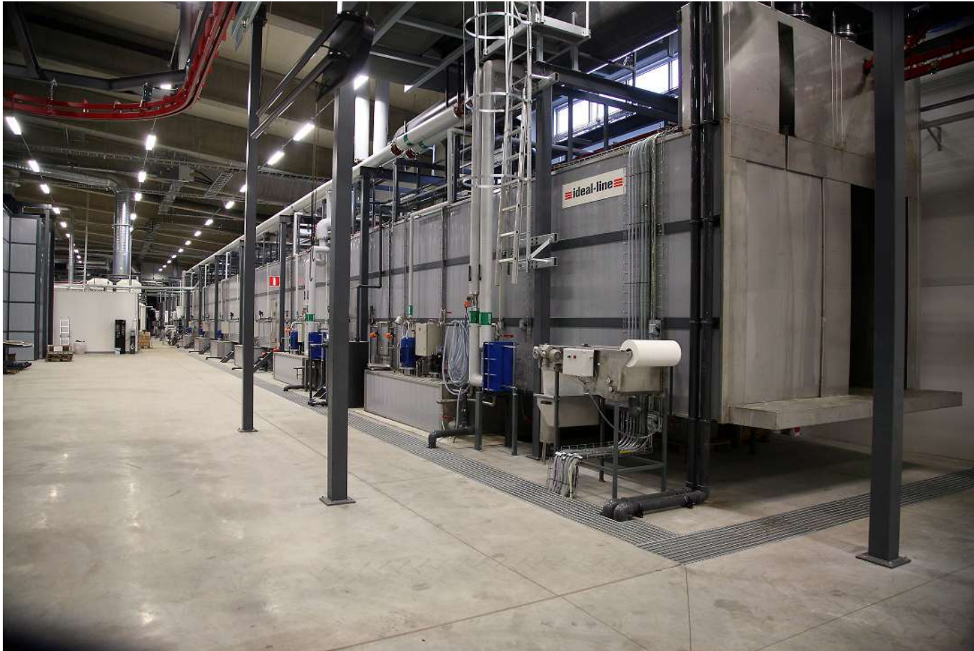
Vorbehandlungsanlage mit Zinkmanganphosphatierung und anschließender Aufbereitung des Spülwassers.
